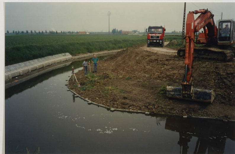
Proostdijkvaart - Bij verlaagd waterpeil wordt de paaiplaats - bij de samenvloeiing met de Steengracht - afgewerkt.
